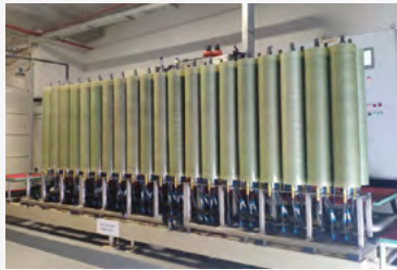
新加坡工业废水处理 处理量：150t/d
